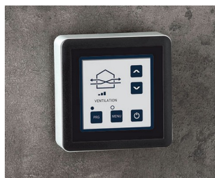
Contrôle du système de ventilation
