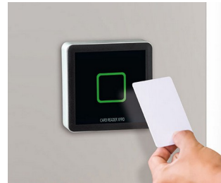
Système de contrôle d'accès RFID
