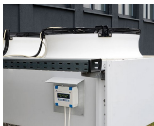
Commande de chauffage/climatisation/ventilation
